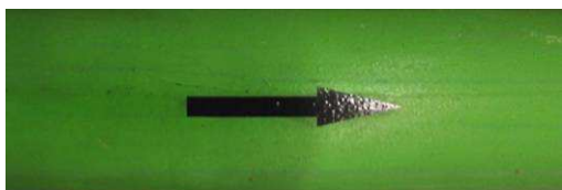
Figura 36 - Sinalização de rede de água de refrigeração. (Fonte – Imagem obtida nas instalações Saint Gobain Mondego)
