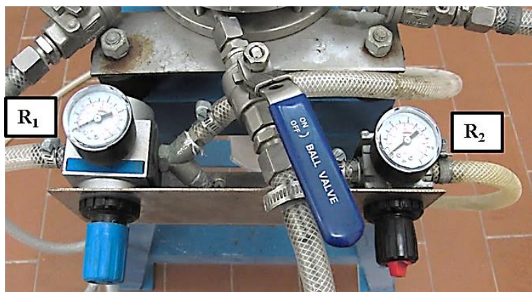
Figura 3.8. Reguladores de pressão do sistema.
