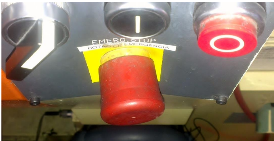
Figura 5.5 Botão de Emergência danificado
