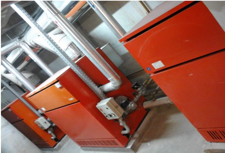
Figura 3.3. Imagem das caldeiras.
