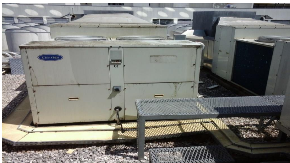
Figura 3.5. Imagem das chillers.
