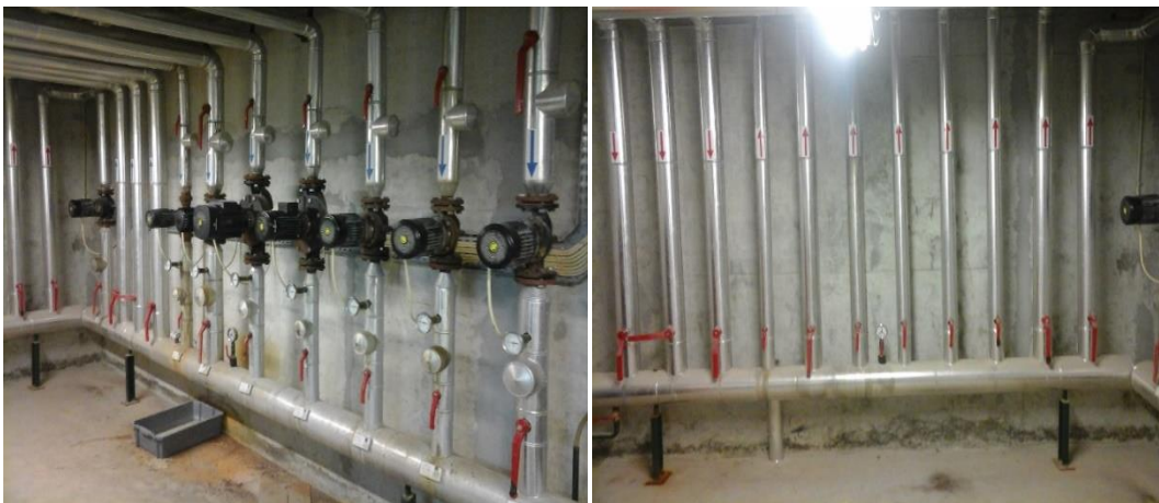
Figura 3.4. Imagem das eletrobombas.
