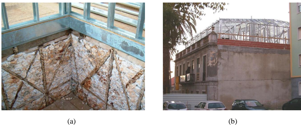
Figura 2.2 – Exemplo da utilização de perfis enformados a frio na reabilitação e remodelação: (a) remodelação de um edifício com gaiola pombalina [6] e (b) reabilitação de uma cobertura [6]
