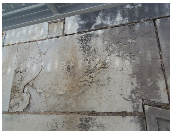
Figura 7.29: Delaminação localizada na fachada com necessidade de consolidação.
