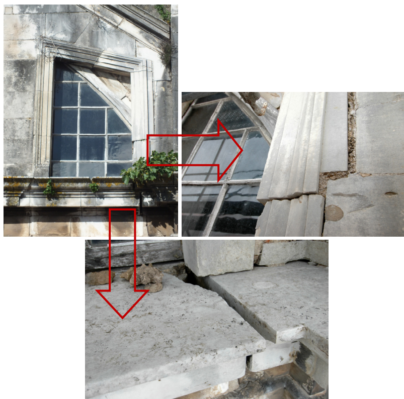
Figura 7.6: Pormenor de patologias apresentadas na zona superior da Igreja.
