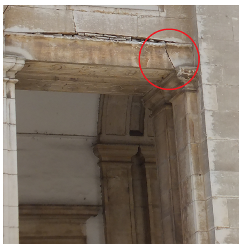
Figura 7.9: Lintel fraturado na zona inferior da Igreja.
