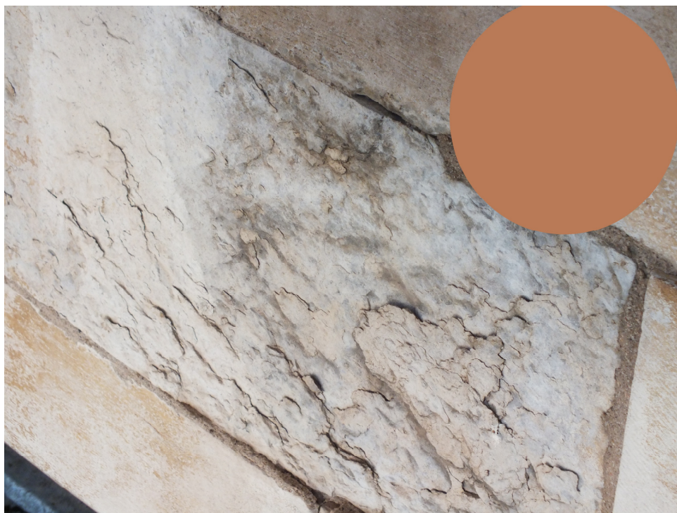
Figura A.8: Delaminação.
