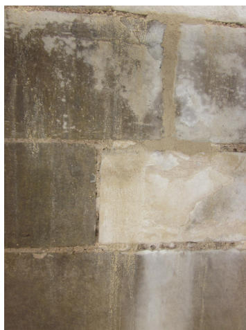
Figura 7.41: Estrago causado pela entrada de água nas novas juntas de argamassa.
