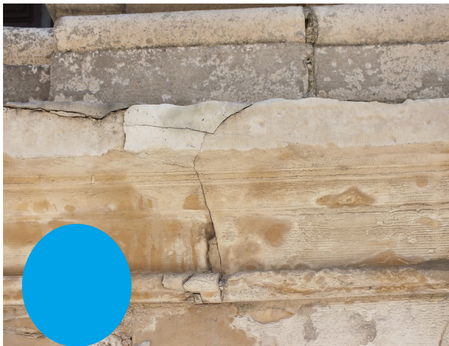
Figura A-4: Fissura.
