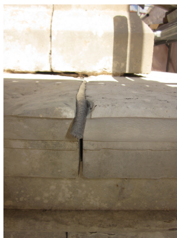
Figura 7.42: Proteção provisória de juntas abertas.
