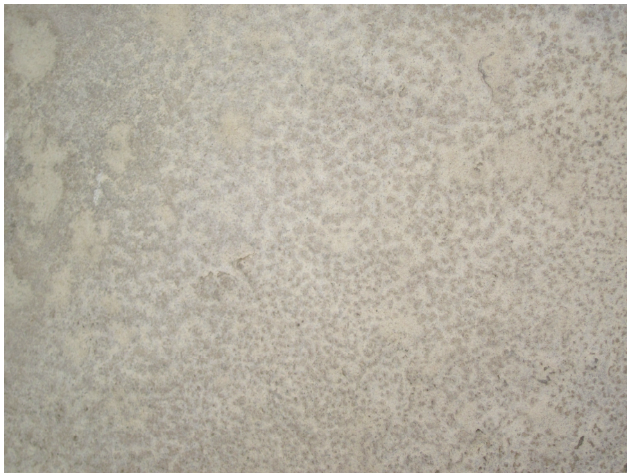
Figura B.4: Pitting/ picamento.
