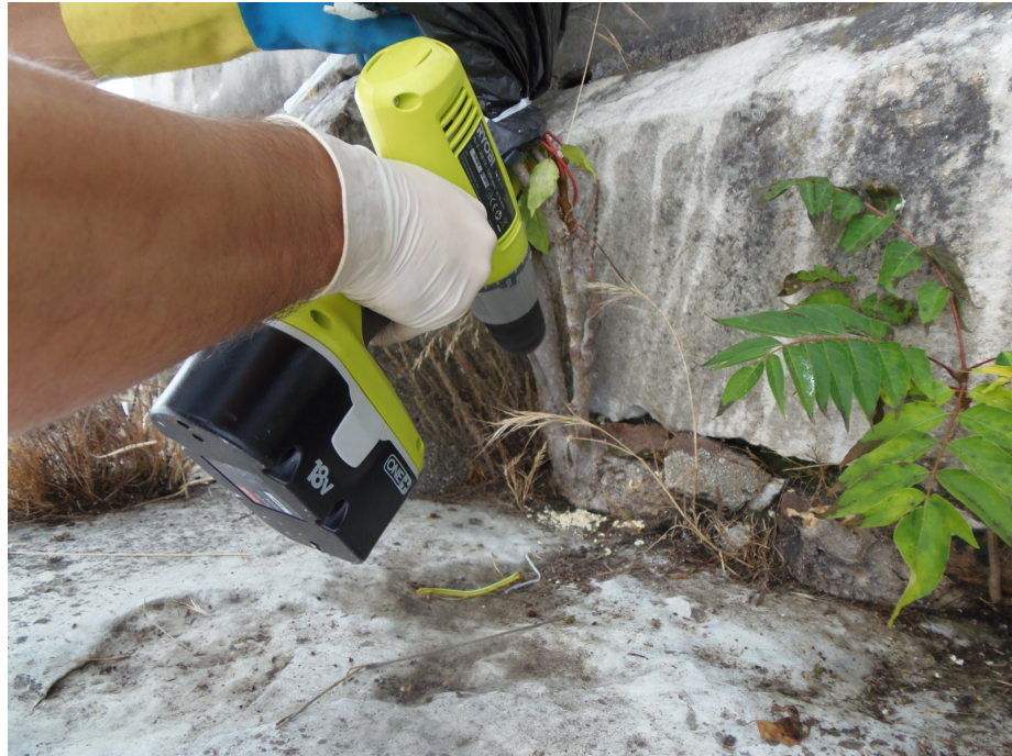
Figura C-5: Perfuração das raízes de plantas superiores. (fornecida por equipa de restauro).
