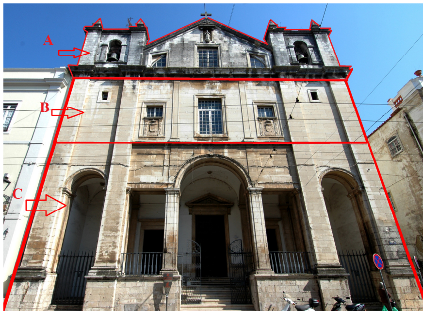
Figura 7.1: Representação das diferentes zonas da fachada da Igreja do Carmo(A:zona superior; B:zona intermédia; C:zona inferior).
