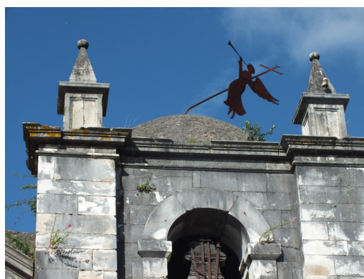
Figura 7.5: Patologias presentes na torre sineira mais a Este.
