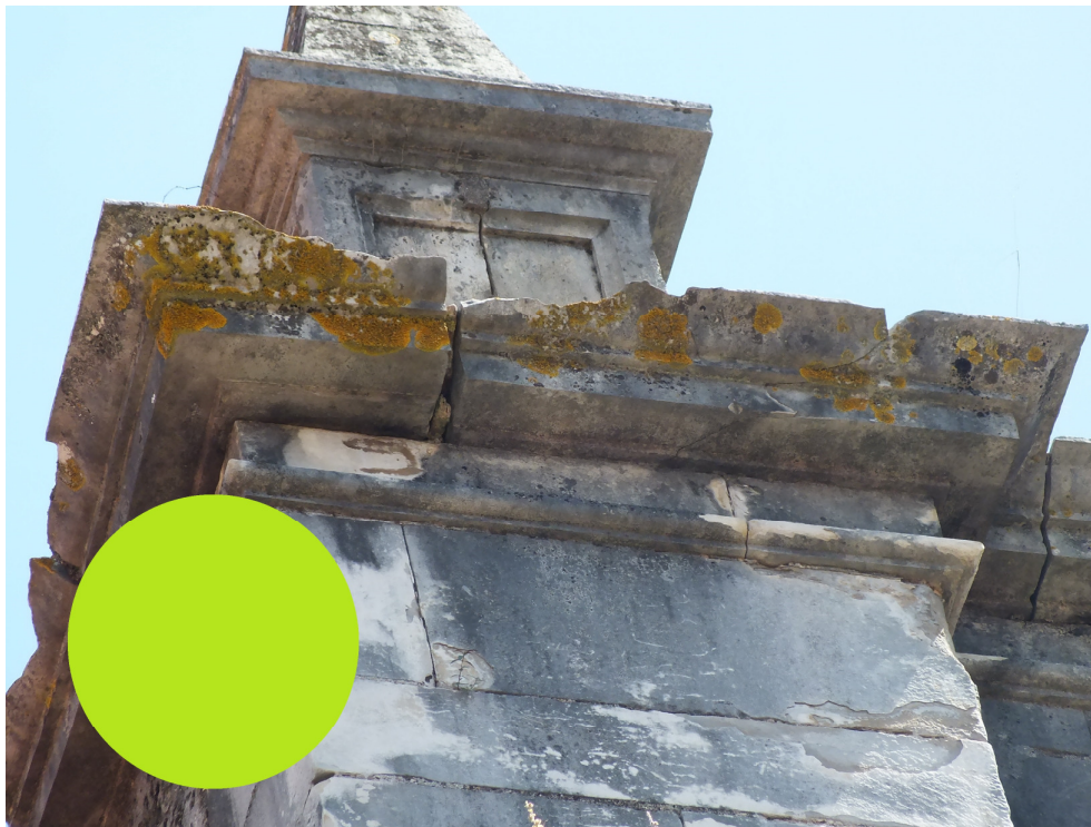
Figura A.11: Líquenes e perda de material.
