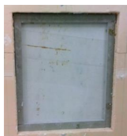
Figura 5.18 - Painel de pedra com pedra na sua envolvente e caixa-de-ar vazia (imagem obtida antes da aplicação da placa de pedra)
