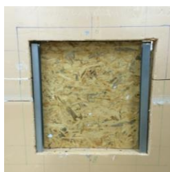
Figura 5.15 - Painel de OSB com chapa lateral e caixa-de-ar vazia (imagem obtida antes da aplicação da placa de OSB)
