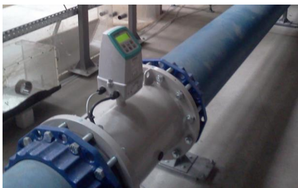
Figura 3.5 – Caudalímetro de jusante da instalação experimental.
