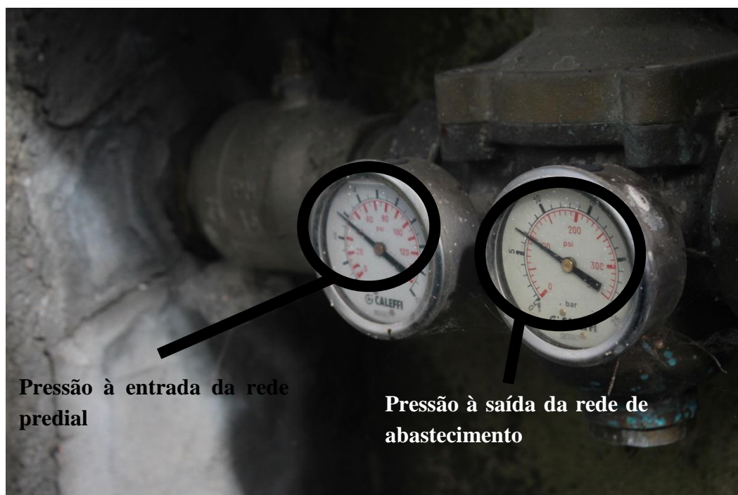
Figura 4.8 – Válvula redutora de pressão à entrada da rede
