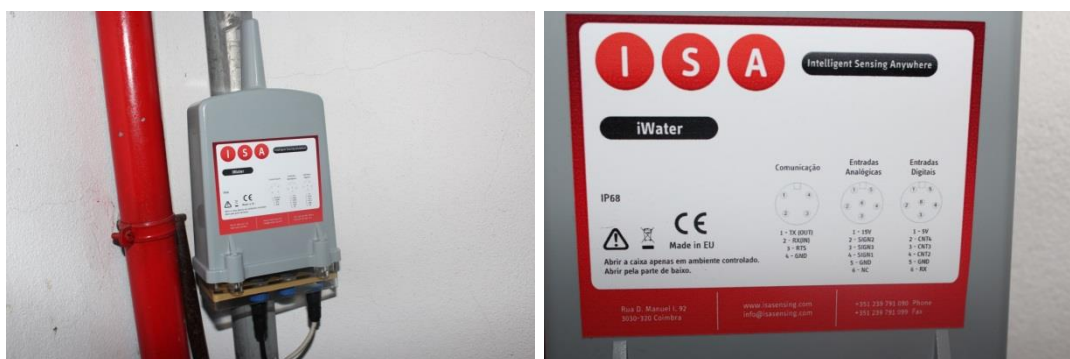
Figura 4.14 – Datalogger fornecido e instalado pela ISA
