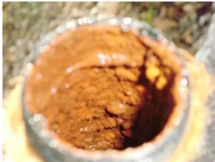
Figura 4.21 – Canalização em adiantado estado de degradação
