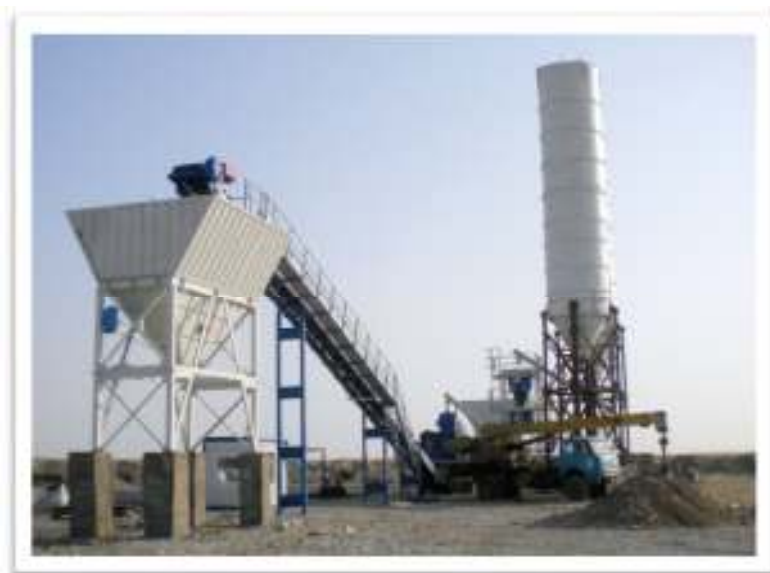
Figura 3.4 - Central contínua de ABGEC
