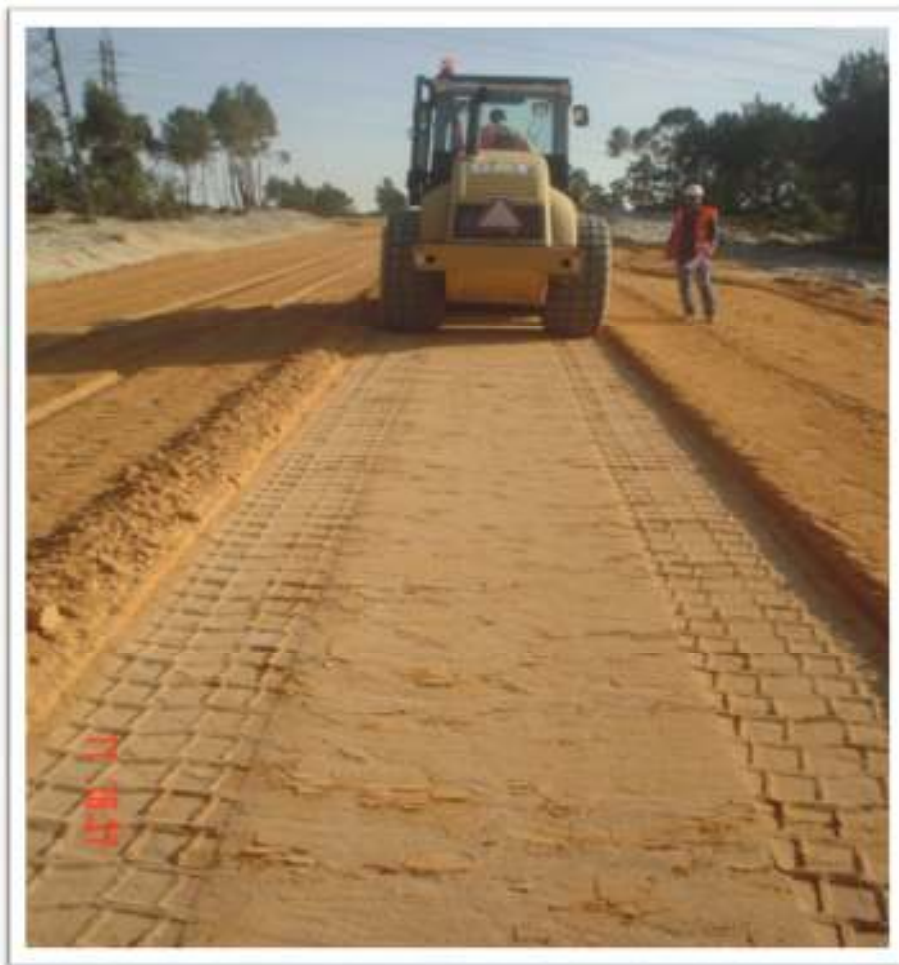
Figura 3.1 – Compactação do solo
