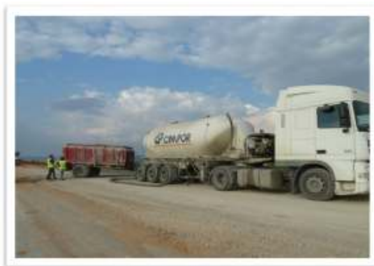
Figura 3.11 – Silos móveis de cimento
