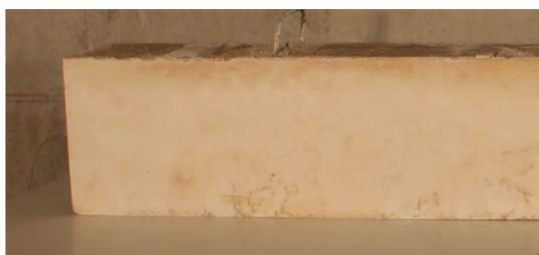
Figura 3.12- Manchas na cor em Viga VM
