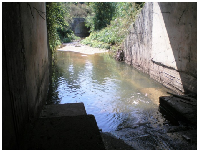
Figura 3.8 – Descarregador de Tempestade da Casa do Sal (jusante) (Pina, 2013)
