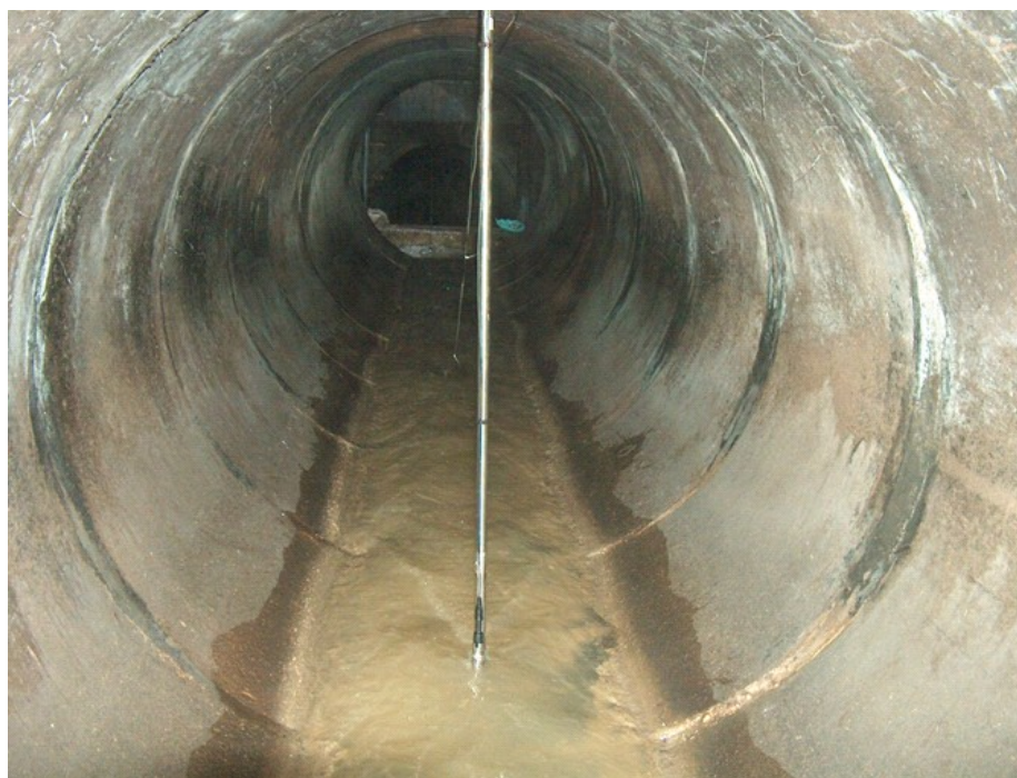
Figura 3.10 – Coletor e descarregador existentes na zona do Mercado Municipal (Pina, 2013)
