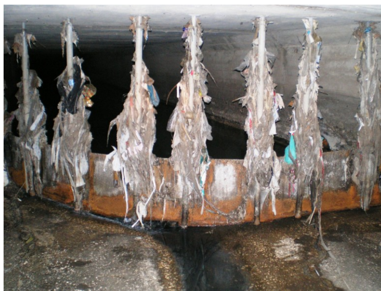
Figura 3.9 – Descarregador de Tempestade da Casa do Sal (montante) (Pina, 2013)
