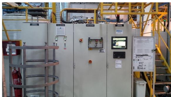
Figura 4.3 Central de controlo do forno cinco onde se encontram painel do dissociador, painel dos gases, painel elétrico e painel do computador (Mahle Componentes de Motores S.A.).
