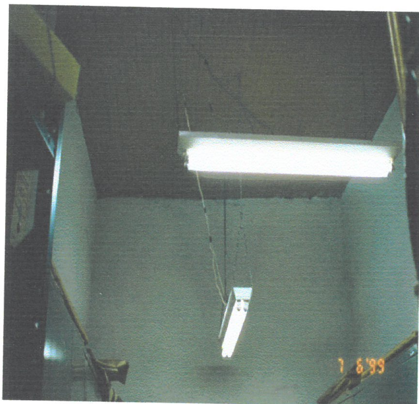
FIGURA 78 - Detalhe da iluminação fluorescente na sala de arquivo, onde nota-se a fiação aparente.
