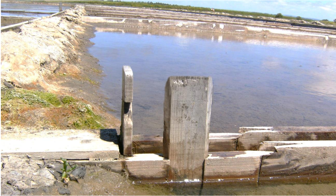
Fotografia 8- Aplicação das palhetas de “tipo1” e de “tipo 2” no caneiro em madeira.
