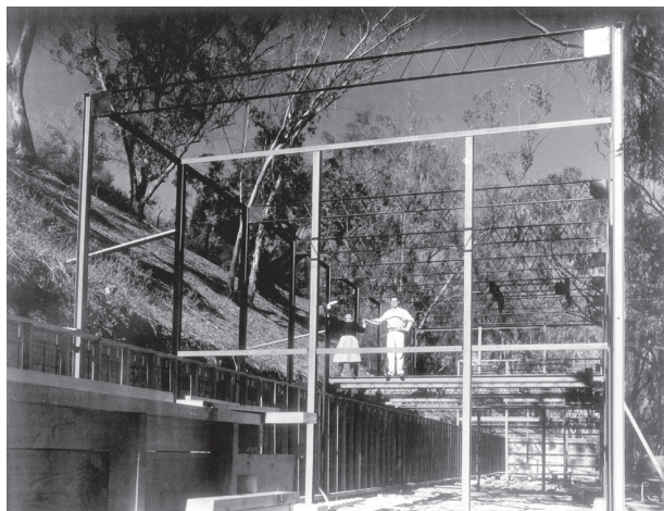
Foto da CSH#9 em construção com Charles e Ray Eames olhando para o mar.
