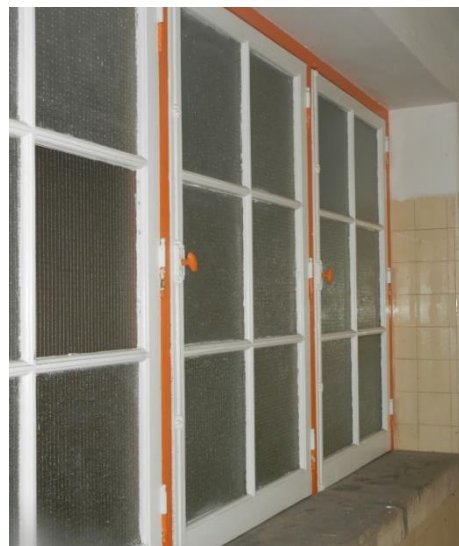
Caixilho ao nível do pavilhão de ginástica no interior, com comunicação com a antiga piscina e actual sala de ginástica
