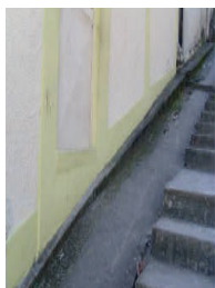
Foto 02 - Rua Augusto Borborema Detalhe de canalizações existentes e relação com soleira
