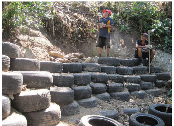
122. Muralha de pneus em construção, Parque Ecológico, Favela Vidigal, Rio de Janeiro, Brasil, Abril 2016
