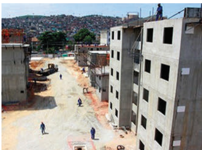
10. Núcleo Habitacional, Favela Nova Brasília, Complexo do Alemão, Rio de Janeiro, Brasil
