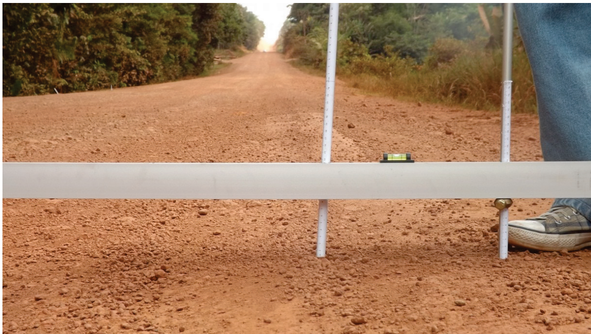
Fotografia 6: Régua móvel disposta para medição das profundidade dos defeitos no terrapleno da via. Fonte: Pesquisa de campo
