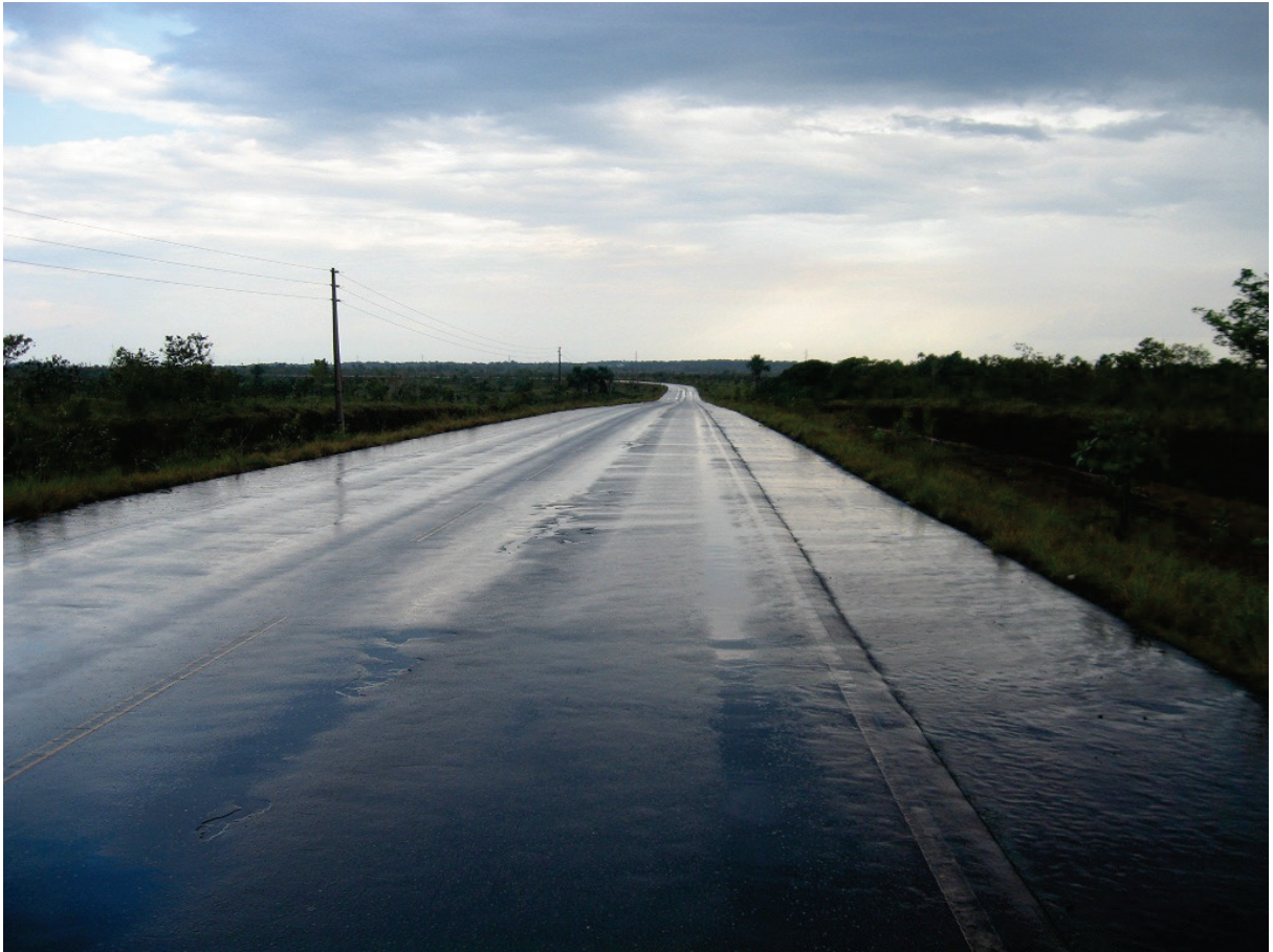
Fotografia 3: Lâmina d'água em afundamento de trilha de roda no trecho 156BAP0250 da BR-156.
