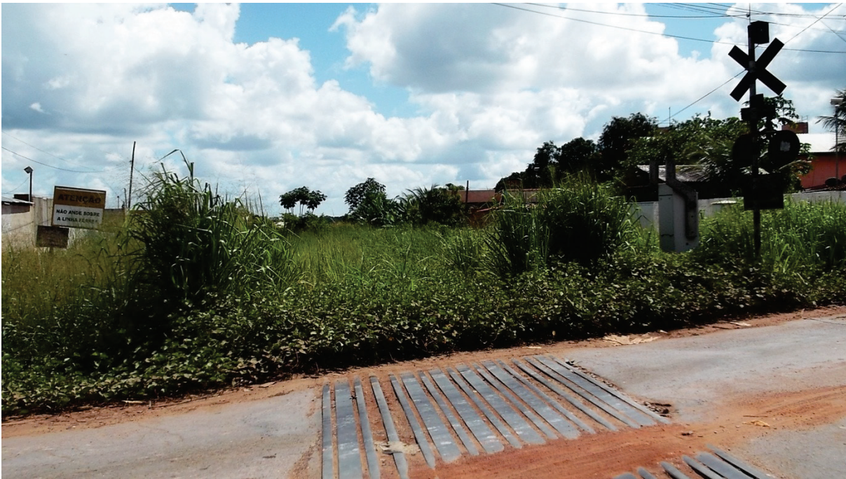
Fotografia 17: Trecho da EFA em passagem de nível no km 9, completamente tomado pela vegetação.
