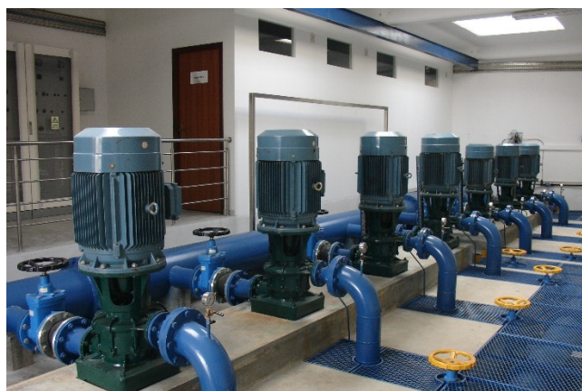
Figura 1 – Grupos elevatórios constituintes de uma estação elevatória.
