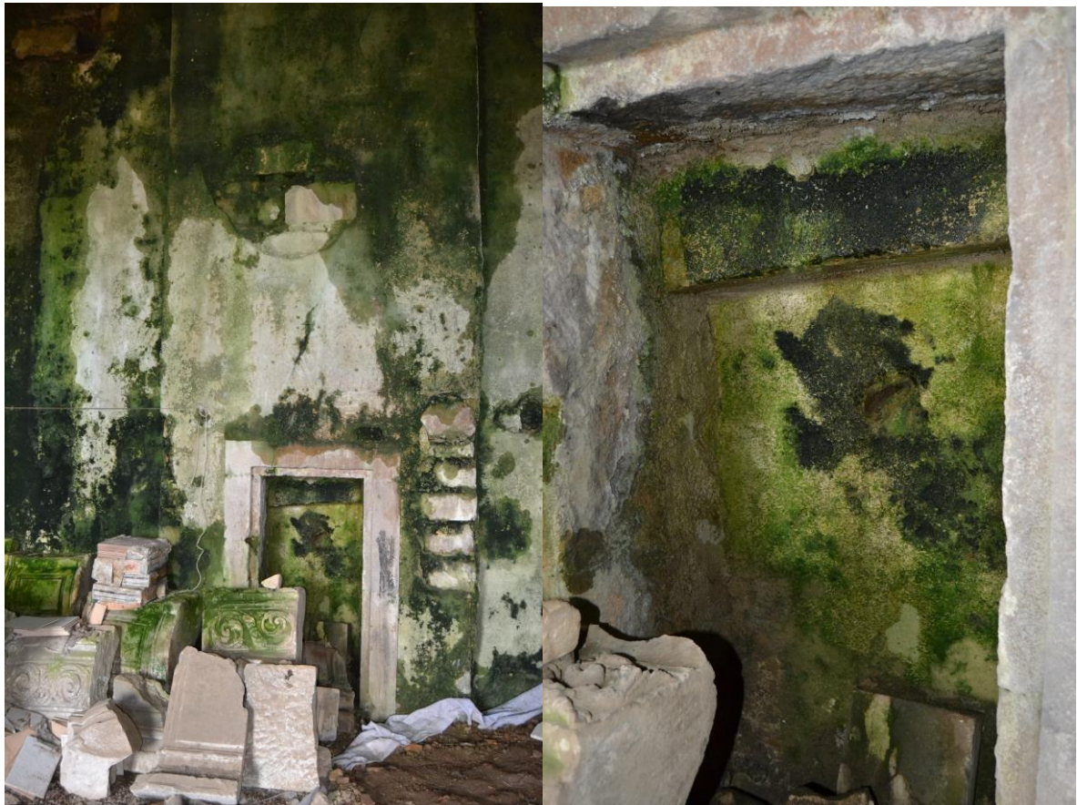
7./Ilustração 23: Fotografias, de 28 de Julho de 2014, de um pormenor da fachada sul do interior da torre da Sé, da autoria de Jorge Ferreira. A pesquisa no local parece indicar que o troço saliente, que parecia corresponder a uma chaminé, o era, afinal, por razões meramente estéticas e não funcionais.
