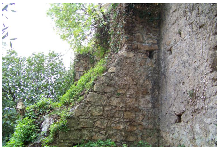
8./Ilustração 132: Muros contrafortados a norte na antiga cerca dos Jesuítas. Fotografia da autoria de Jorge Ferreira, de 22 de Outubro 2012.
