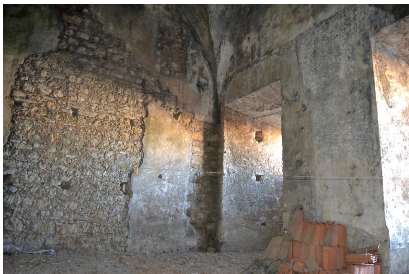
7./Ilustração 26: Fotografia de 2 de Fevereiro de 2013, do interior da torre da Sé (fachadas poente e norte), da autoria de Jorge Ferreira.
