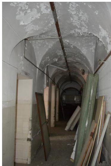
8./Ilustração 104: Espaço no entrepiso que mostra a altura que teria o piso inferior antes da sua edificação, através da visualização do topo dos vãos em arco. Fotografia de Jorge Ferreira, de 1 Novembro de 2013.
