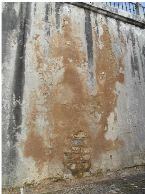
7./Ilustração 67: A degradação do reboco na parede sul do terreiro da Universidade permite ver o vão, entaipado, da porta do antigo Observatório Astronómico. Fotografia da autora de 15 de Janeiro de 2011.
