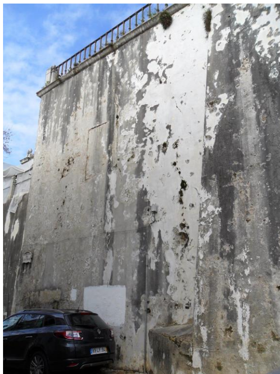
7./Ilustração 63: A fissuração do reboco permite ver um antigo vão, entaipado, fora da área anteriormente ocupada pelo Observatório Astronómico do pátio da Universidade. Corresponderá, talvez, aos espaços pré-existentes, em cave, que figuram nas diversas plantas do Observatório Astronómico. Fotografia da autora, de 15 de Janeiro de 2011. Creio poder tratar-se de uma torre aproveitada posteriormente para fins habitacionais.
