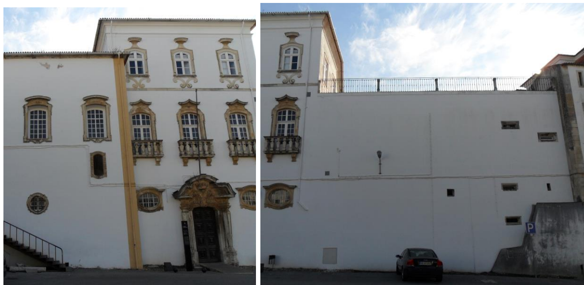
8./Ilustração 65: Espaço reentrante na zona central da fachada principal do Colégio de S. Jerónimo. A torre dos sinos, cortada, da antiga igreja de S. Jerónimo e maciço contíguo (aproveitado para caleira). Fotografias da autora, de 6 de Novembro de 2010.
