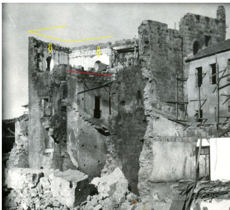
9./Ilustração 110: Extracto de fotografia da torre dos sinos de Santa Cruz, após a derrocada (gentilmente cedida por Jorge Oliveira). As marcações a amarelo e a vermelho relacionam-se com as da ilustração 111.
