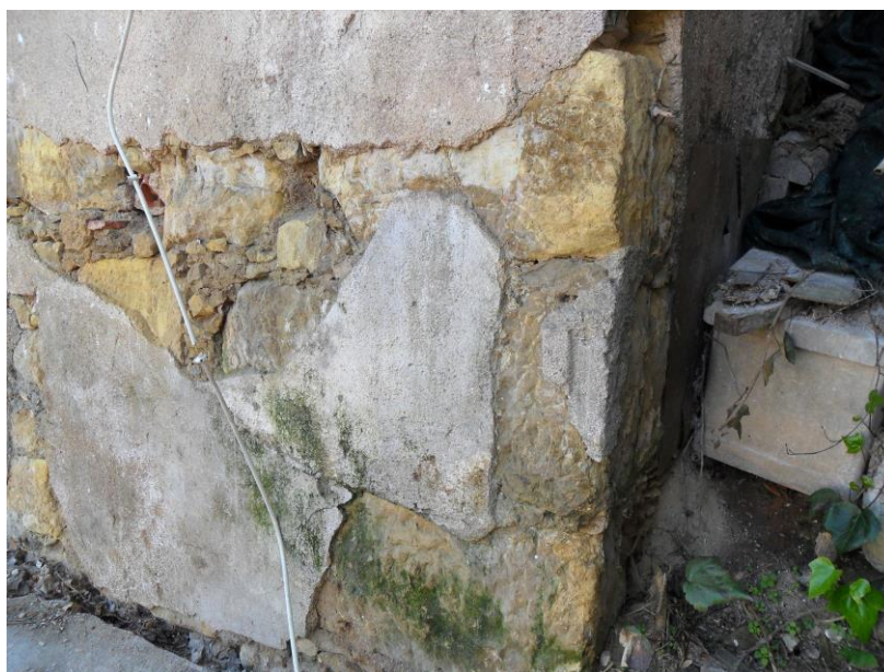
6./Ilustração 270: Pormenor da esquina noroeste da torre sob o edifício com o nº 56 da rua de Padre António Vieira. Fotografia da autora, de 8 de Março de 2012.
