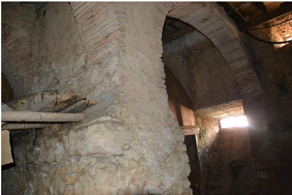
6./Ilustração 295: Arcos de suporte e, ao fundo, um vão na parede norte do edifício com o nº 15-17 da rua da Couraça dos Apóstolos. Fotografia da autoria de Jorge Ferreira, de 11 de Julho de 2013.
