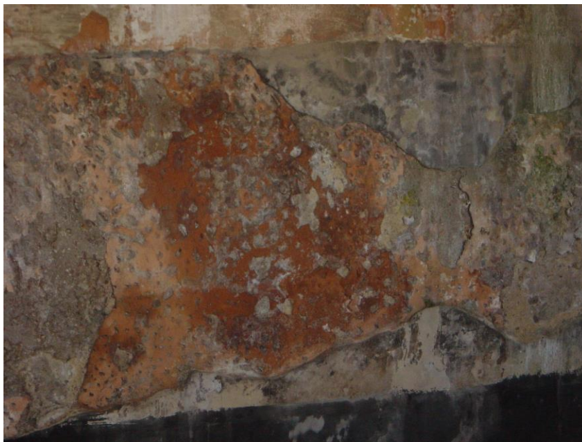
6./Ilustração 72: Fotografia do que parece ser reboco colorido nas paredes da cisterna do antigo colégio de Santo António da Estrela. Fotografia da autoria de Jorge Coelho, de 21 de Setembro de 2007.
