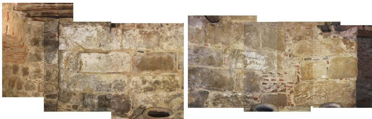
6./Ilustração 98 Casa das Talhas, na rua de Fernandes Tomás (antiga rua das Fangas) nº 58-66. Fotografias com a marcação do que parecem ser os cunhais de uma terceira torre a norte da Torre quinária da Estrela, sobre a muralha. Fotografias da autoria de Augusto Pestana, de 18 de Janeiro de 2014. Montagem de Jorge Ferreira.
