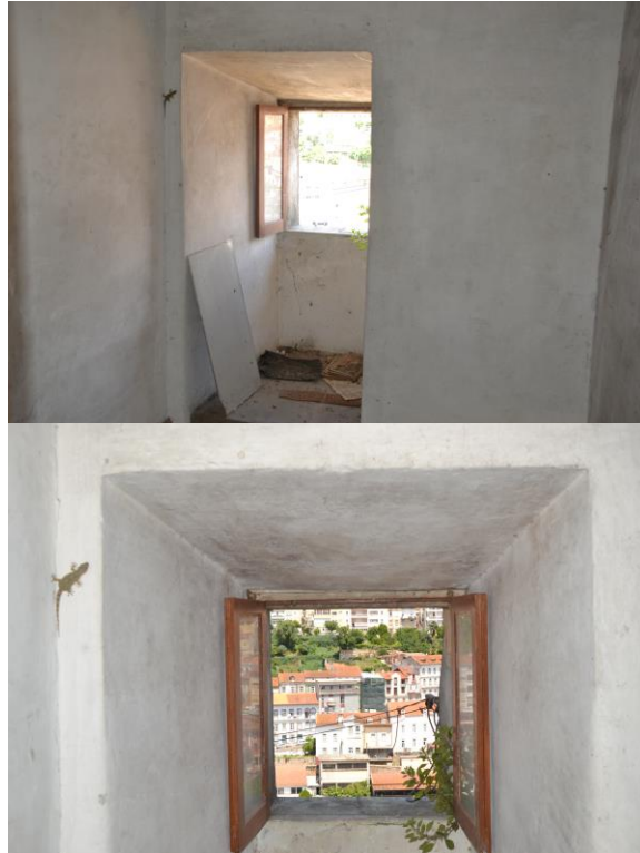
6./Ilustração 290: Paredes exteriores, muito espessas, da fachada norte do edifício com o nº15-17 da rua da Couraça dos Apóstolos. Fotografias da autoria de Jorge Ferreira, de 20 de Junho de 2013.
