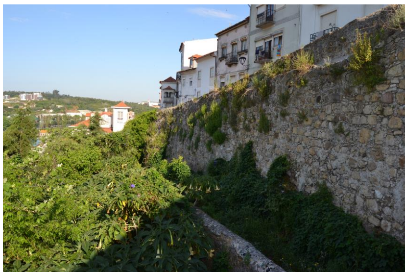
6./Ilustração 203: Fotografia da barbã na base da muralha. Fotografia da autoria de Augusto Pestana, de 11 de Julho de 2013.
