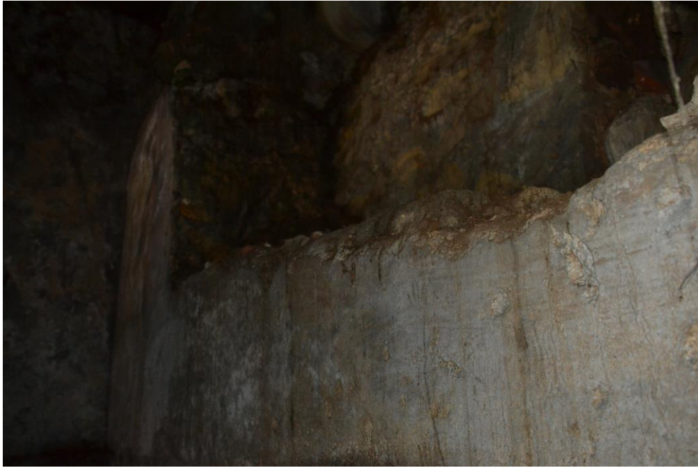
6./Ilustração 294: O vão no canto sudeste do edifício com o nº 15-17 da rua da Couraça dos Apóstolos e que se encontra a uma altura considerável do chão, acima do espessamento da parede sul (parede que poderá corresponder a um troço da fortificação). Fotografia da autoria de Jorge Ferreira, de 11 de Julho de 2013.
