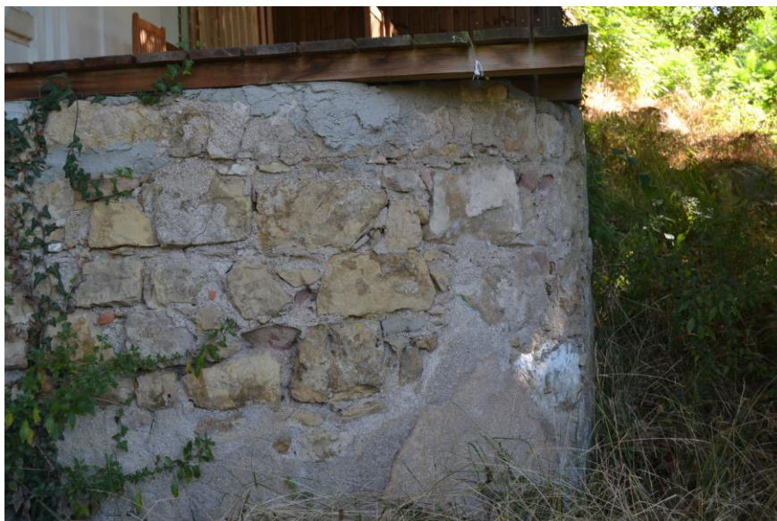
6./Ilustração 234: Maciço redondo sobre o qual assenta um pavimento de madeira de uma varanda do edifício do piso mais baixo, em cave, do Instituto de Justiça e Paz. Fotografia da autoria de Jorge Ferreira, de 16 de Setembro de 2013.
