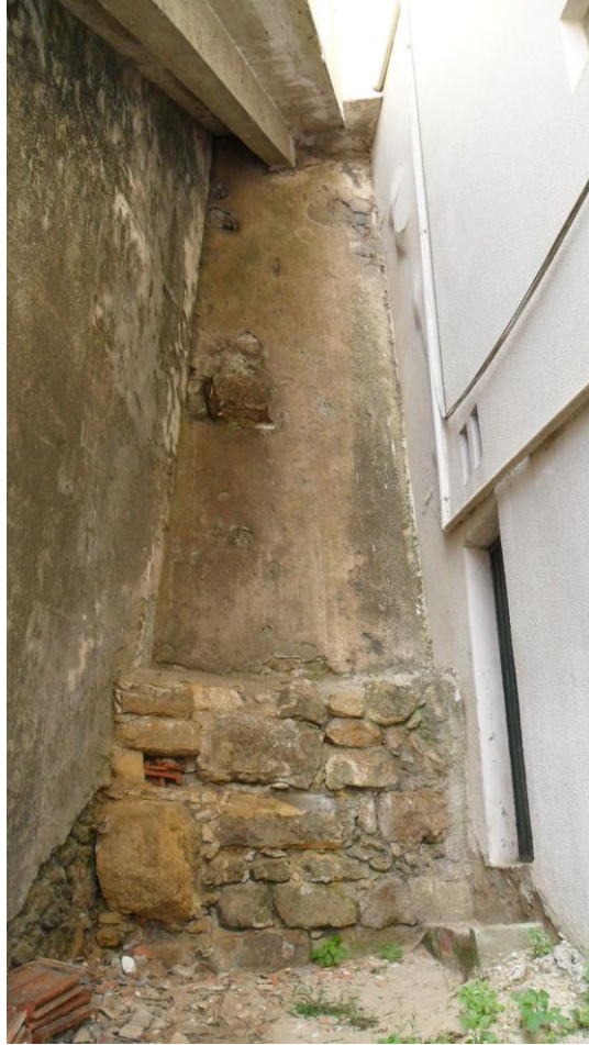
6./Ilustração 271: Muro a sul entre o edifício com o nº 56 da rua de Padre António Vieira e o que lhe fica contíguo, a poente. Fotografia da autora, de 16 de Julho de 2010.
