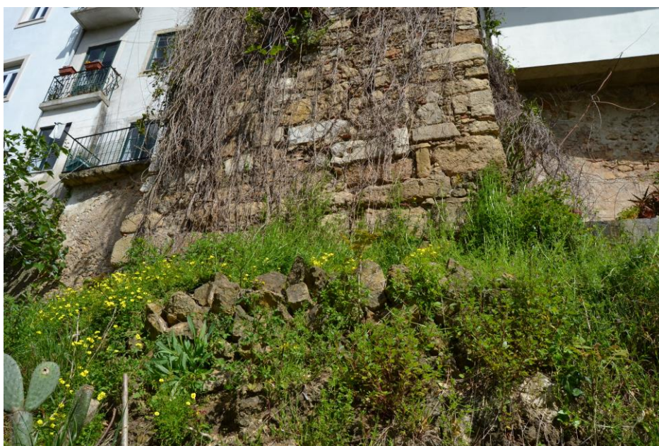
6./Ilustração 180: Pormenor da torre existente imediatamente a poente do nº 30, já no alinhamento do edifício com o nº 22. Fotografia da autoria de Jorge Ferreira, de 11 de Julho de 2013.
