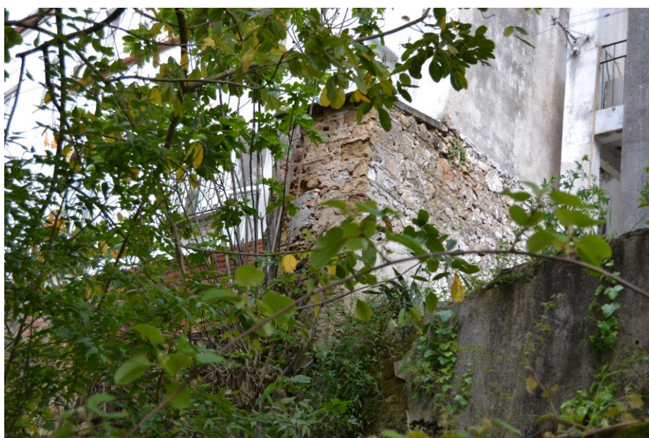
6./Ilustração 185: Pormenor do arranque de um muro com sentido perpendicular à cortina da cerca de Almedina, do lado de fora desta, já no alinhamento do edifício com o nº 16. Fotografia da autoria de Jorge Ferreira, de 11 de Julho de 2013.
