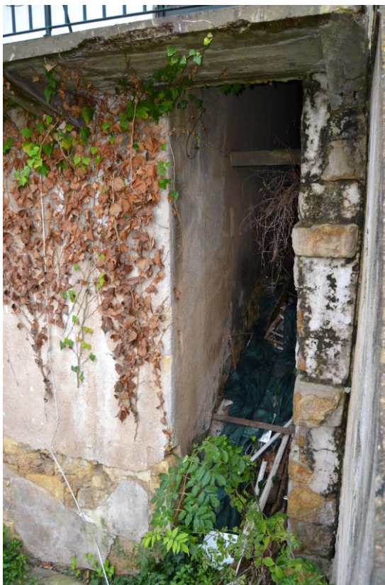
6./Ilustração 269: Espaço, a poente, contíguo à torre sob o edifício com o nº 56 da rua de Padre António Vieira. Fotografia da autoria de Jorge Ferreira, de 7 de Dezembro de 2012.
