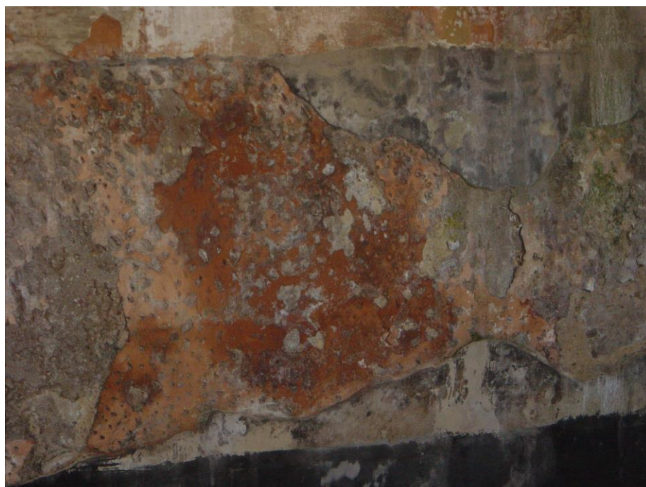
6./Ilustração 116: Vista do interior da cisterna do antigo colégio de Santo António da Estrela, parecendo ver-se várias camadas pintadas sob o reboco. Fotografia da autoria de Jorge Coelho, de 12 de Fevereiro 2007.
