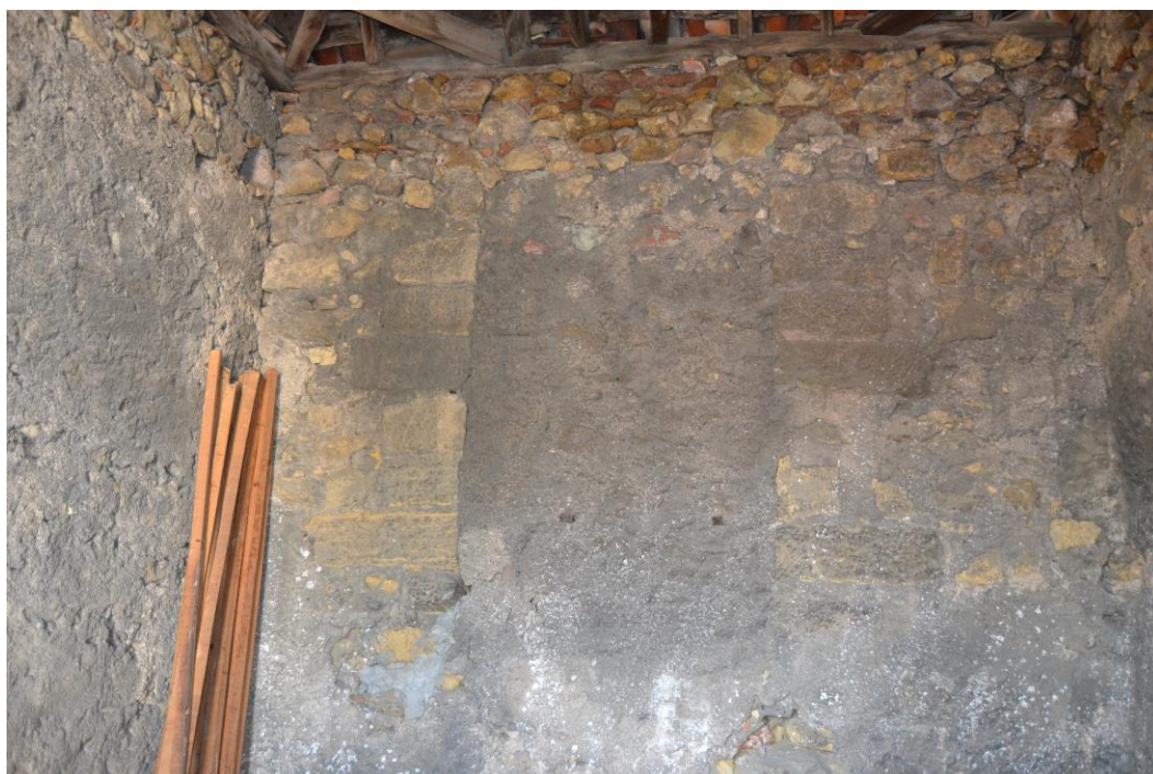
5./Ilustração 79: Parede interior do piso mais alto da torre da igreja do Salvador (lado norte). Fotografia de 11 de Julho de 2013, da autoria de Jorge Ferreira.
