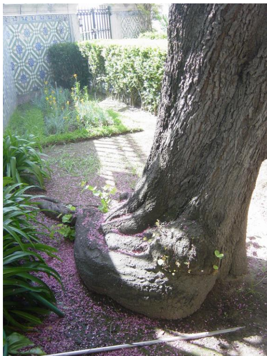
5./Ilustração 23: A árvore que suponho posicionada no meio dos alicerces do arco, estando o crescimento das suas raízes condicionado e a levantar o pavimento do claustro. Foi removida em Março de 2014. Fotografia da autora, de 23 de Abril de 2007.
