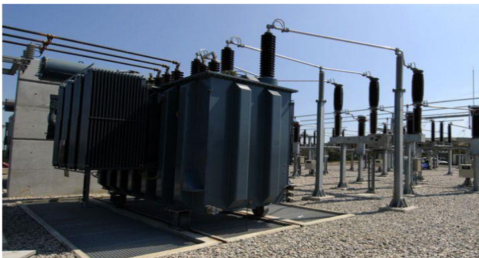
Figura 61- Subestação AT/MT. Transformador de potência e linhas de transmissão (Wind Farm Construction, 2015).
