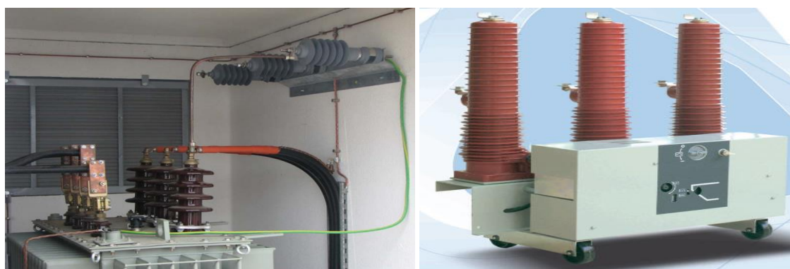
Figura 41- Travessias de um transformador e respectivos descarregadores e disjuntor com isolamento a gás SF 6 (EDP Distribuição, 2010) (Efacec, 2015)
