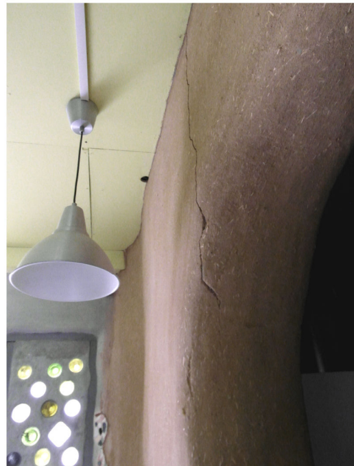
Fig 87_Fendas provocadas pela instabilidade do solo.
