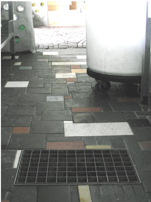
Fig 86_Grelhas de ventilação no pavimento da cozinha.
