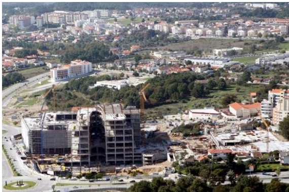
Fig. 48 Novo Palácio do Gelo em fase de construção. Foto de autor anónimo, 2008.
