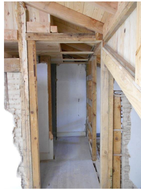
44 | Fotografia captada durante a obra do tabique de madeira; Fonte: Arq. Carla Paulo.
