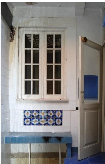
54 e 55 | Humidade no piso térreo, em cima e no piso 1, em baixo. Fonte: Walter Rossa.
