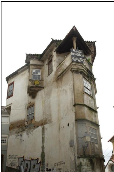
Figura 3 - Casa da Nau. Imóvel de Interesse Público, classificado desde 1960, em avançado estado de degradação. Edifício da República “PraKistão”.
