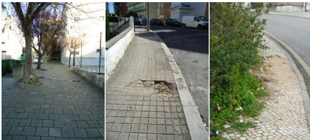
Figura 5.2: Exemplo de passeios degradados em Aveiro e em Coimbra
