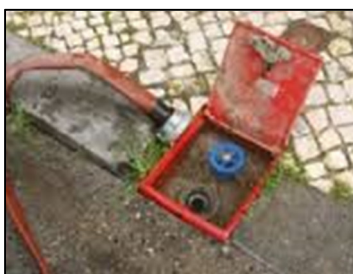
Figura 4 - Hidrante cheio de areia.
