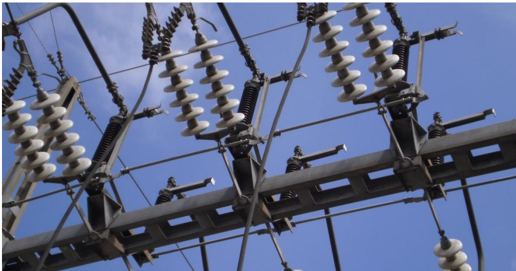
Figura 28: Seccionadores de um circuito trifásico de 60KV.
