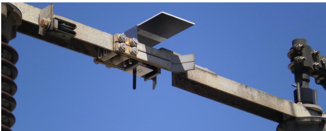
Figura 33: Segunda instalação em seccionadores.
