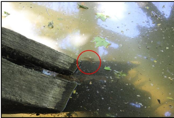
Presença de xilófagos nos pilares de madeira
