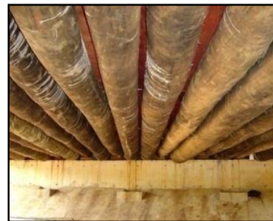
(Ponte 02 do Campus II da USP – vista inferior do tabuleiro) Fonte: (Calil Jr, 2006)
