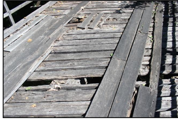
Pavimento em péssimo estado de conservação
