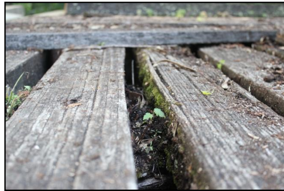
Acumulação de lixos entre ripas (sobre as longarinas)
