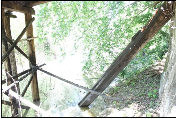
Rotura de longarina do tabuleiro
