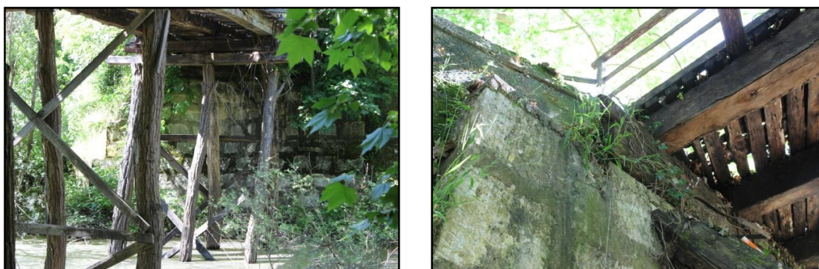
Pórtico com os três pilares derrubados
