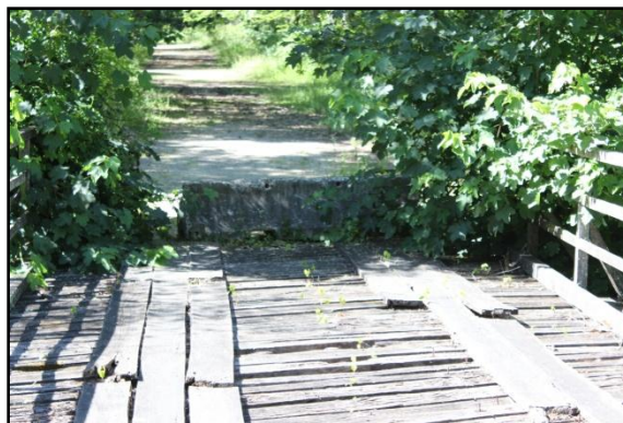
Falta de limpeza junto aos encontros
