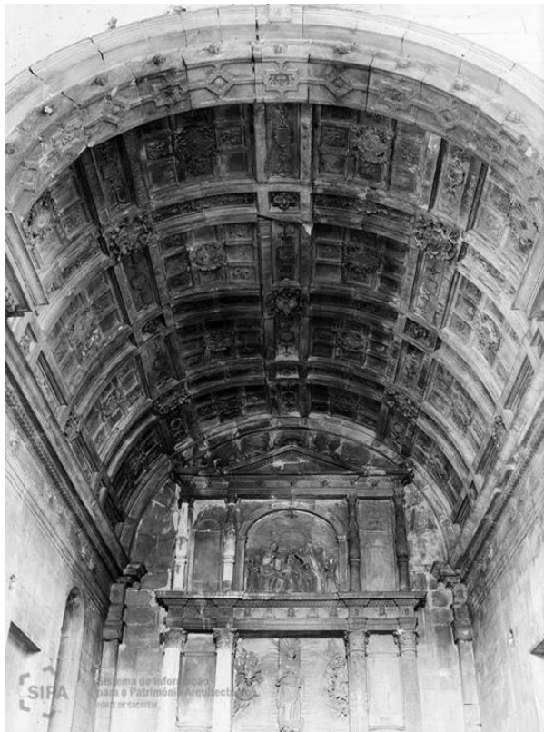
418 – Abóbada da capela do tesoureiro em risco de ruir.
