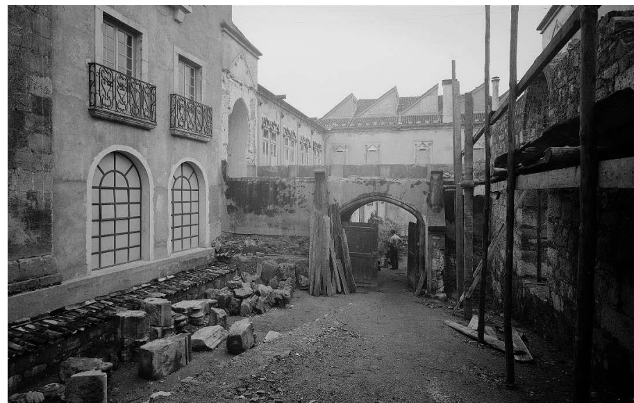
234 – No lado esquerdo: fachada do antigo saguão situado a Nordeste; ao centro: antigo passadiço neomanuelino; no lado direito: início da construção do novo pavilhão.
