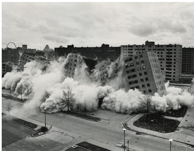
Fig. 11 – Pruitt-Igoe de Minoru Yamasaki, Saint Louis, Missouri, 1960. Implosão do complexo habitacional em 1972 por não atender satisfatoriamente às necessidades da população para a qual foi construído.
