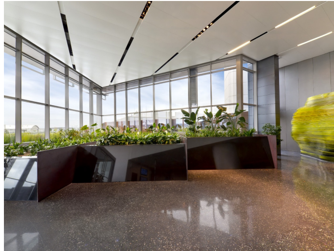
Fig. 41 – Sistema Living Machine no interior do edifício Port of Portland em Portland, EUA.
