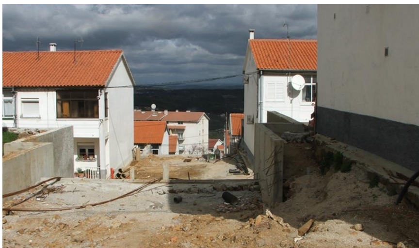
Bairro da Fisel durante as obras de requalificação, fotografia cedida pelo Atelier do Boído.
