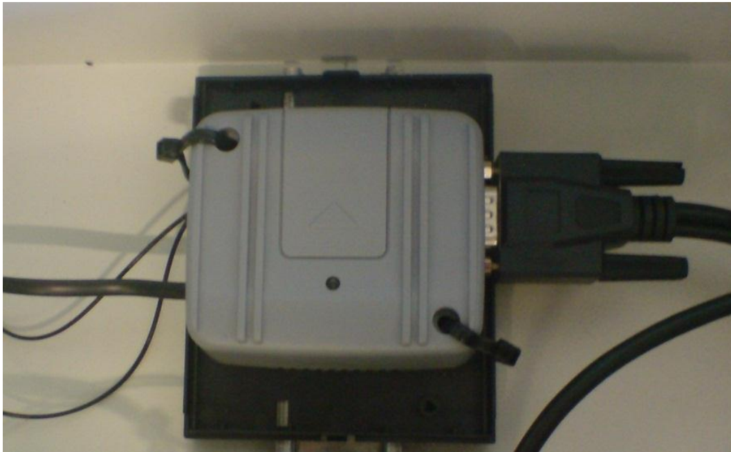
Unidades integradoras nas subestações – Foto 4
