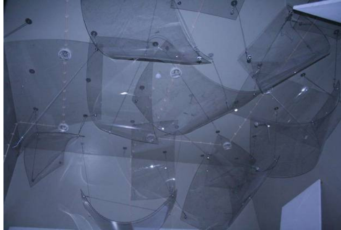
Figura 5.10: Difusores fixos, constituídos por painéis em policarbonato, dispostos no tecto da câmara horizontal fixa.
