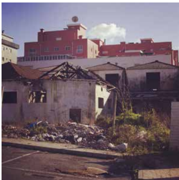
Fig. 107 – Traseiras do edifício da Confiança após um dos incêndios, em 2012.
