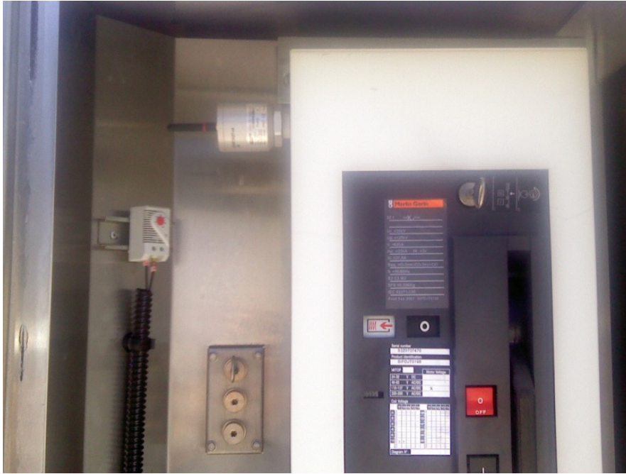
Figura 133 - Instalação do sensor de aceleração e temperatura sem fios no interior do armário.
