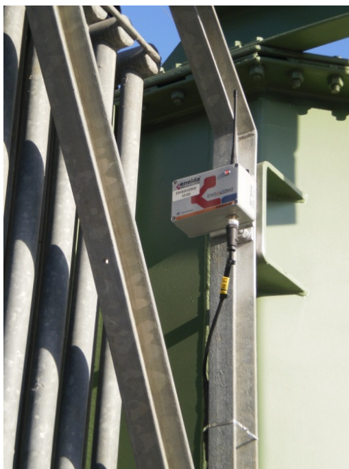
Figura 153 - Router 433 MHz associado a um dos transformadores de AT-MT.
