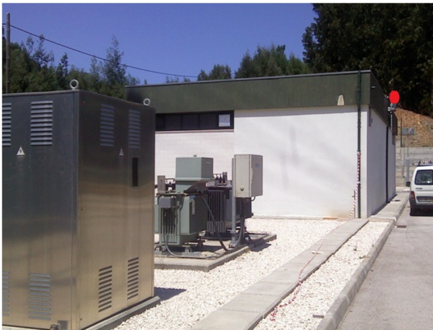
Figura 134 - Distância que separa o armário do disjuntor de MT e a unidade concentradora da rede sem fios (a vermelho).
