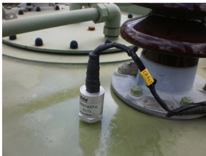
Figura 152 - Sensor de vibração e temperatura EWS TA3T-c instalado na carcaça do transformador de alta-média tensão.
