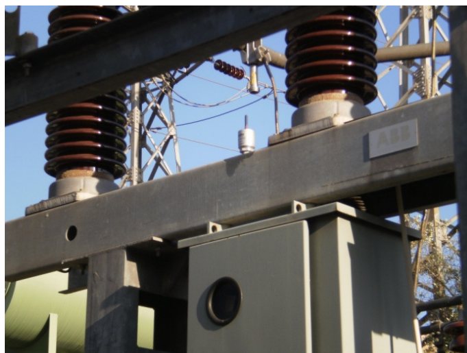
Figura 155 - Sensor de vibrações e temperatura 433 MHz instalado sobre o disjuntor de alta tensão.
