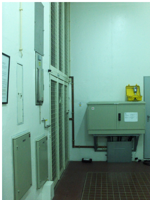
Figura 141 - Sala onde ficou instalada a gateway /Coordenador e a interface humana. a sala onde se encontram os pontos de monitorização está à esquerda da porta gradeada.
