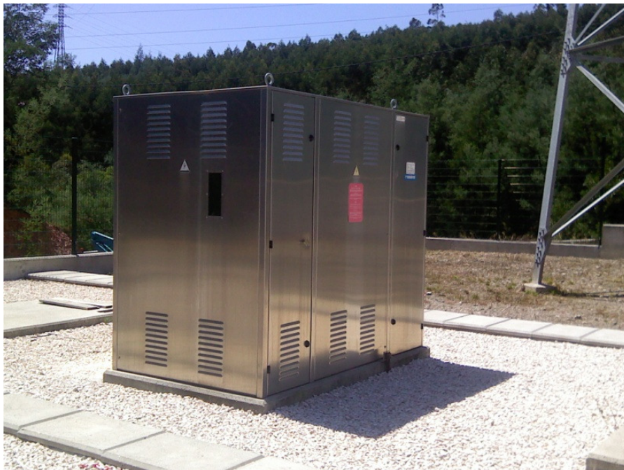
Figura 132 - Armário com disjuntor de média tensão.
