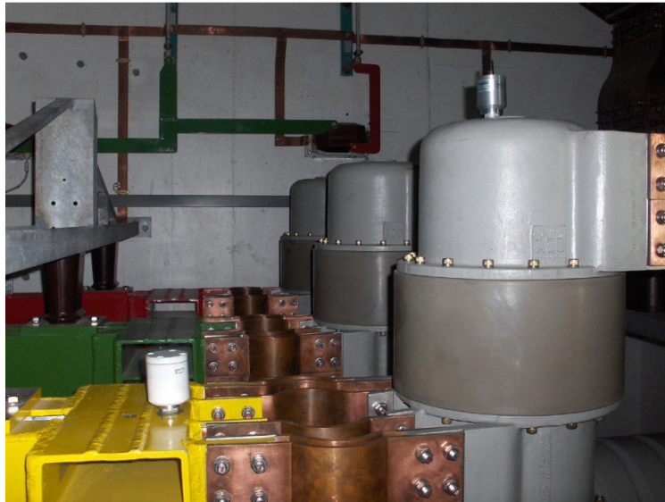
Figura 140 - Sensores de temperatura instalados sobre o barramento de alta tensão (esquerda) e disjuntor (direita).
