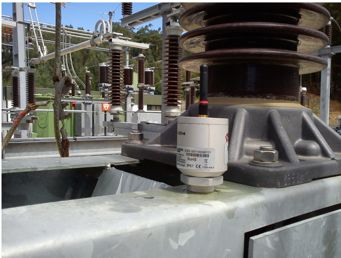
Figura 135 - Sensor EWS TA3T-r4 instalado no terreno.
