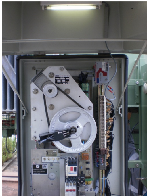
Figura 151 - Sensor de corrente EWS TIST-c instalado no transformador de alta-média tensão.
