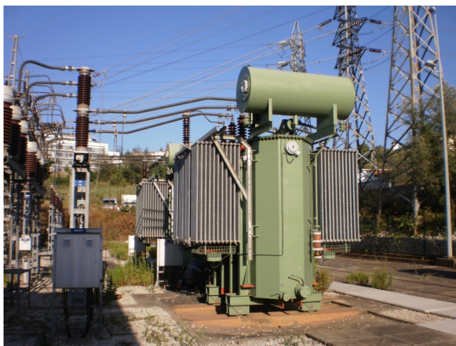
Figura 154 - Transformadores de alta-média tensão.
