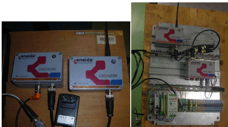
Figura 116 - Sistema subestação eléctrica para testes CEM - à esquerda estão as unidades para interface com o computador e visualização de dados e à esquerda a platine com as unidades sob teste.
