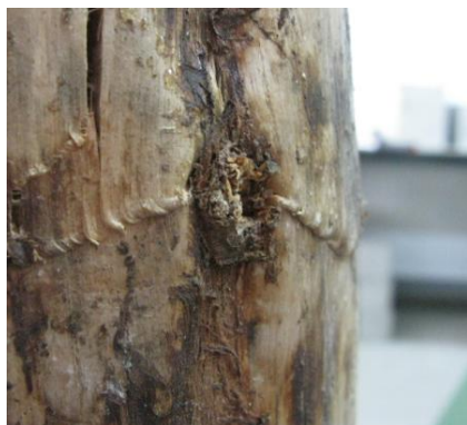
Figura 3.24 – Rotura na proximidade de nós
