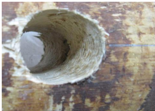
Figura 6.34 – Ovalidade do furo devido a esmagamento provocado pela cavilha
