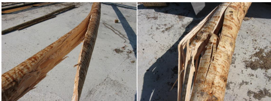
Figura 5.44 – Exemplos de roturas dos postes
