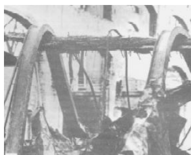
Figura 2.3 – Viga de madeira suportando vigas de aço após incêndio (Júnior e Dias, 1997)
