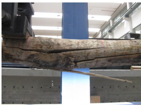
Figura 3.20 – Rotura numa secção com nós
