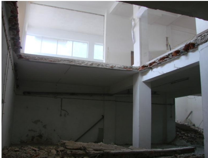
Demolição de laje captando luz para o piso -1 (junto à montra de rua).
