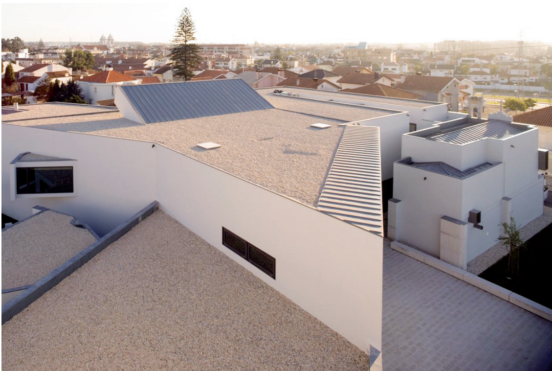
Fig. 123 - Cobertura do edifício (clarabóia que ilumina secção de adultos e átrio de acolhimento)
