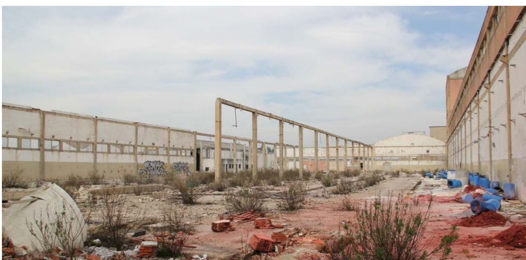
Fig. 237-244 | Estado atual da Estaca
