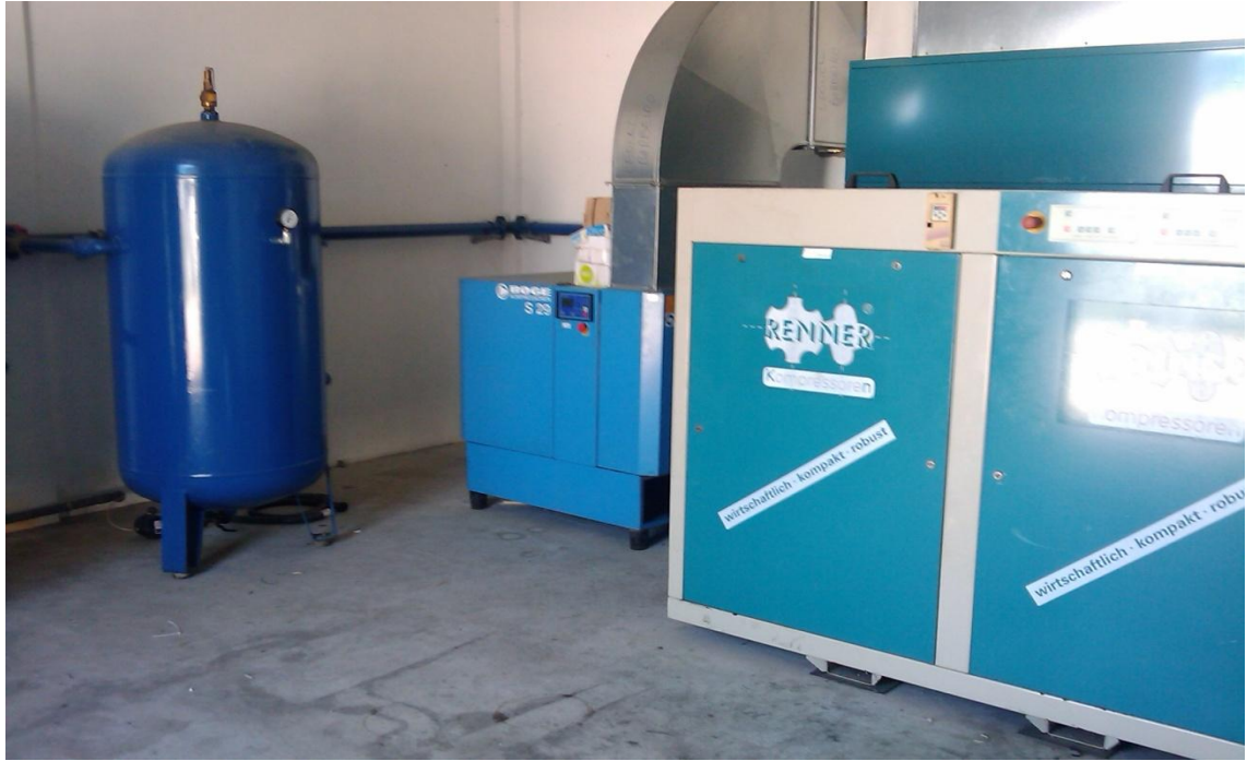
Figura 8 - Unidade de ar comprimido com variador de velocidade.
