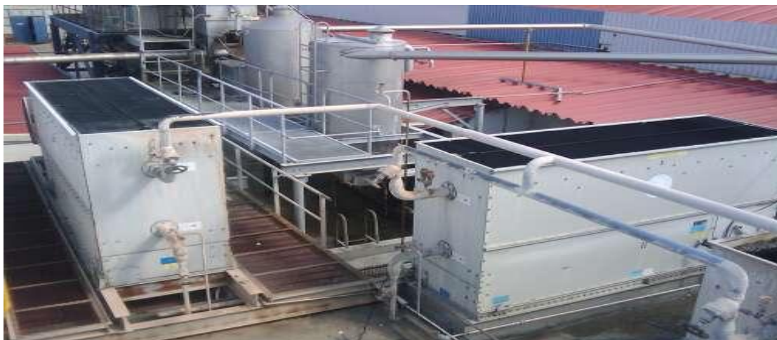
Figura 7 - Condensadores a água, do sistema de refrigeração.
