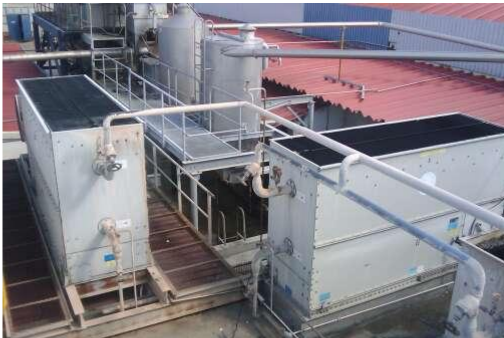
Figura 13 - Condensadores de amoníaco com funcionamento a água.
