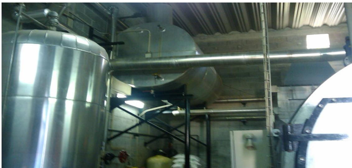
Figura 9 - Depósito de retorno de condensados e economizador.
