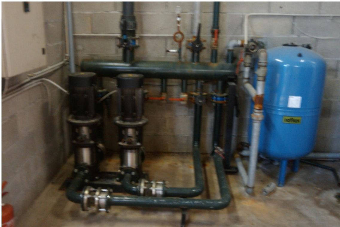
Figura 10 - Sistema de bombagem de água dotado de VEV.
