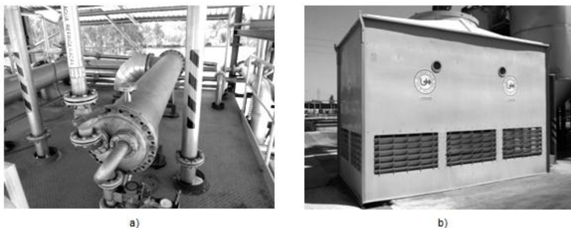
Figura 2.3 – Condensador de uma das colunas de destilação simples (a) e torre de arrefecimento de maior capacidade (b).
