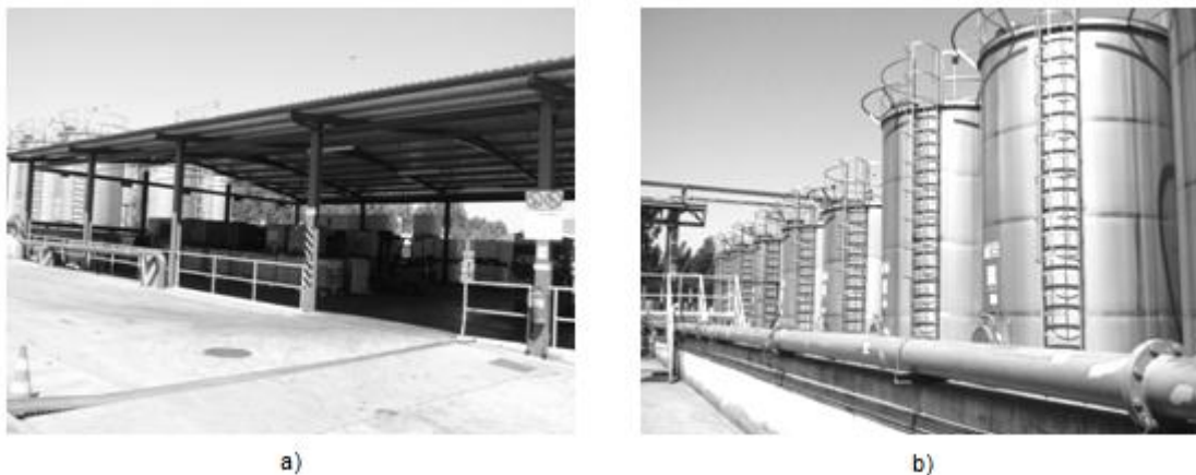
Figura 2.1 – Zona de triagem de solventes (a) e tanques de armazenamento de solvente (b).
