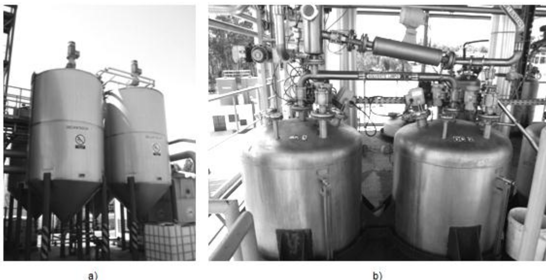
Figura 2.5 – Decantadores (a) e tanques de destilado de uma das colunas de destilação simples (b).
