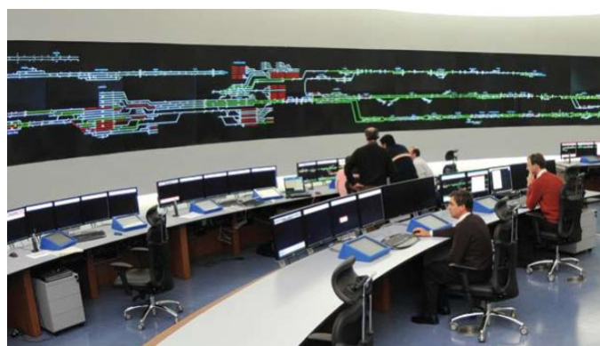
Fig 23 - Interior do CCO do Porto
