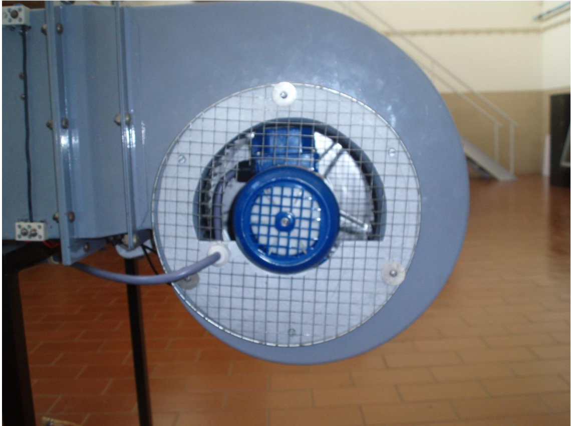
Fig.30 Motor trifásico e apoio de fixação
