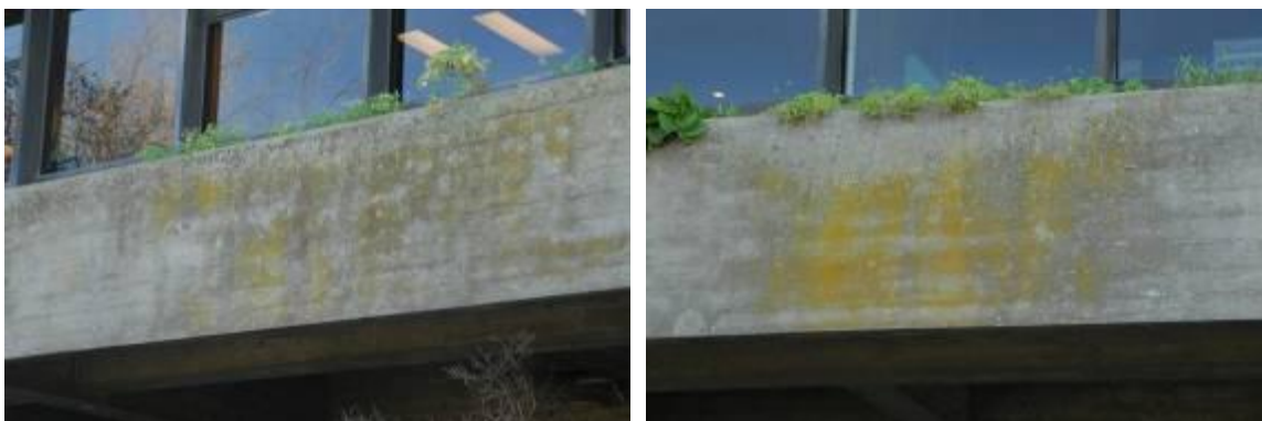
Figura 152. Colonização biológica nas platibandas do edifício sede (musgos e líquenes).
