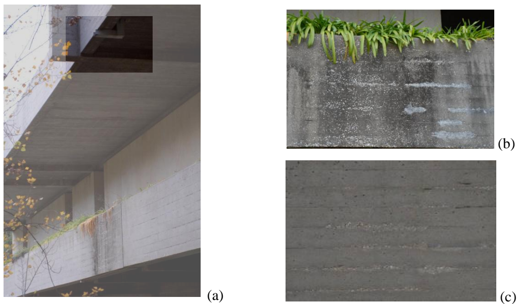
Figura 156. Erosão da camada superficial do betão: (a) vista geral da superfície com destaque da calceira; (b) vista de frente da superfície; (c) detalhe da superfície.
