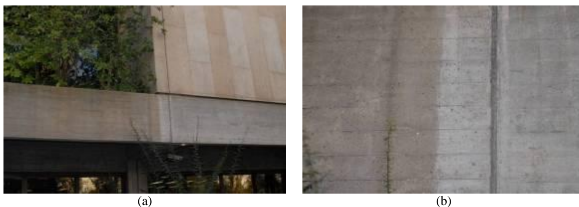
Figura 147. Manchas com depósito de substâncias dissolvidas na fachada Este do museu: (a) vista geral; (b) detalhe.
