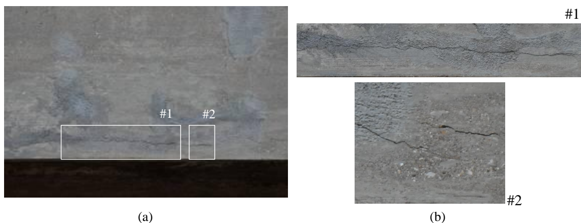
Figura 154. Fendilhação na fachada Sul-Poente do centro de congressos: (a) vista geral; (b) detalhes.
