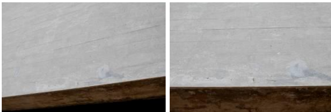
Figura 157. Área com indícios de corrosão.
