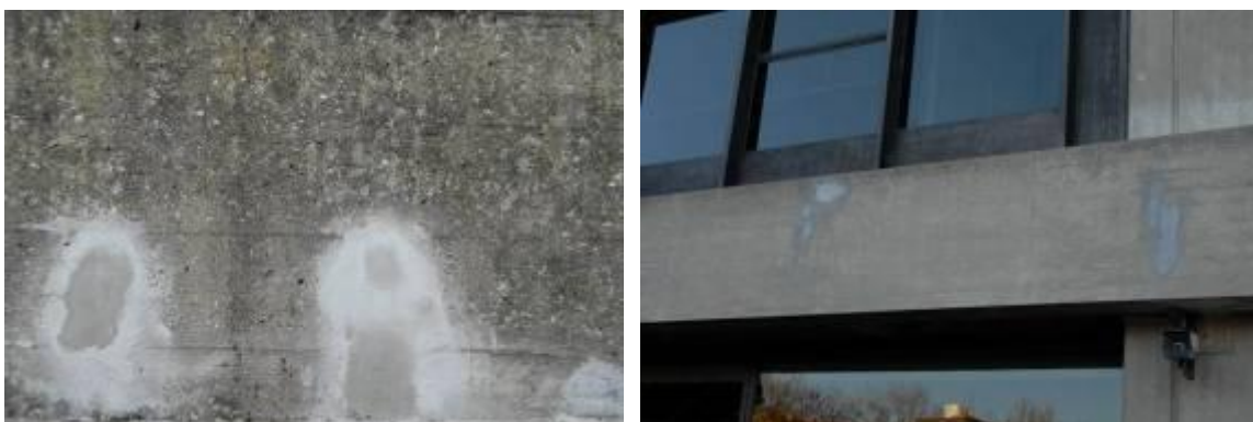
Figura 168. Argamassa de reparação vs. betão do substrato na sede.
