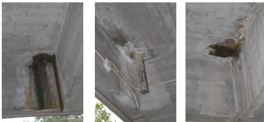
Figura 149. Manchas de humidade e lixiviação da pasta de cimento devido a falhas de impermeabilização junto aos tubos de queda nas consolas do museu.
