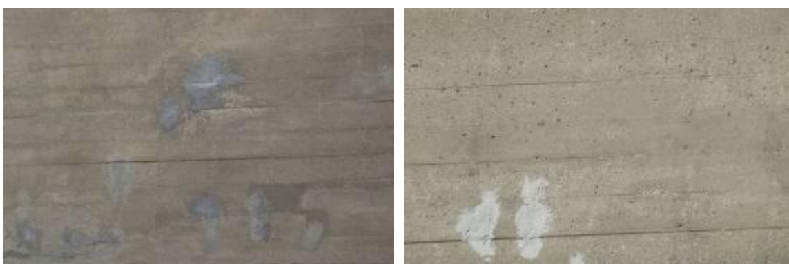
Figura 169. Argamassa de reparação vs. betão do substrato no auditório.
