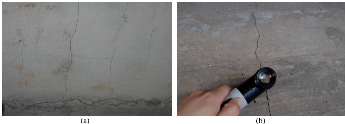
Figura 9. Métodos tradicionais de caracterização de fissuras: (a) esboço junto à fissura; (b) lupa de aumento graduada.
