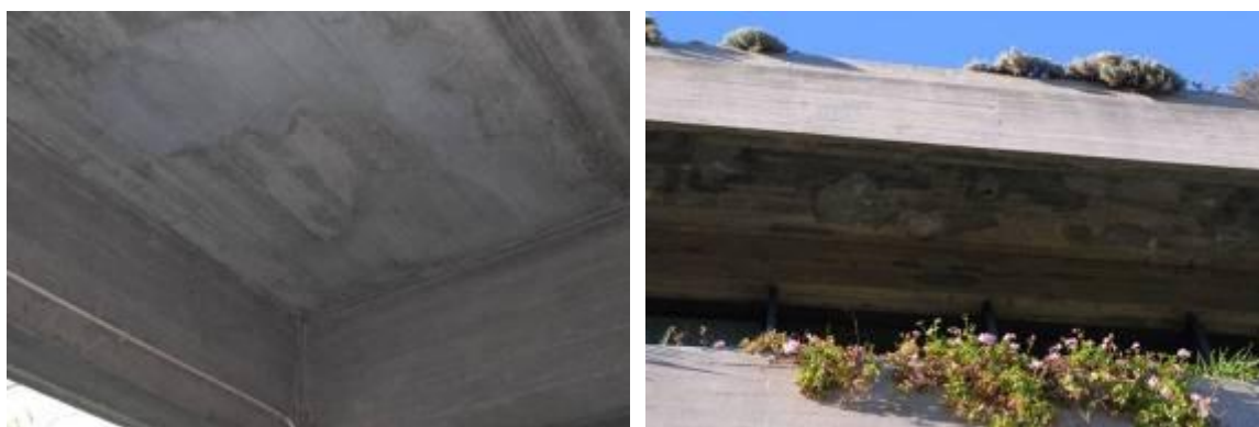
Figura 148. Manchas de humidade e lixiviação da pasta de cimento devido a falhas na impermeabilização.
