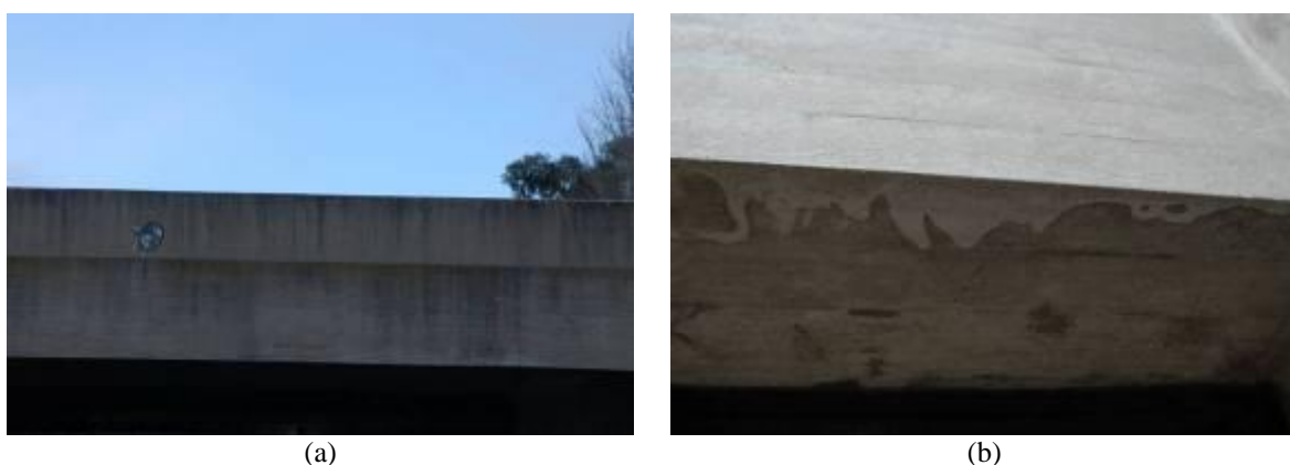
Figura 146. Vigas das platibandas: (a) manchas de sujidade devido a escorrência de águas pluviais; (b) depósito dos compostos hidratados da pasta de cimento.
