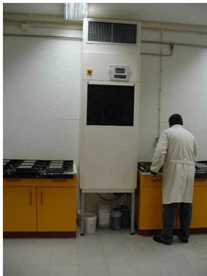
Figura 53 - Equipamento de controlo da temperatura e humidade relativa
