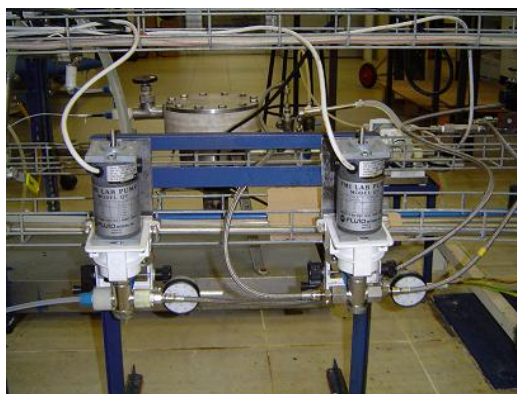
Figura 3.14. Bombas FMI de alimentação do ácido nítrico e do benzeno.
