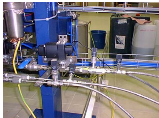
Figura 3.4. Pormenor das válvulas reguladoras de caudal.
